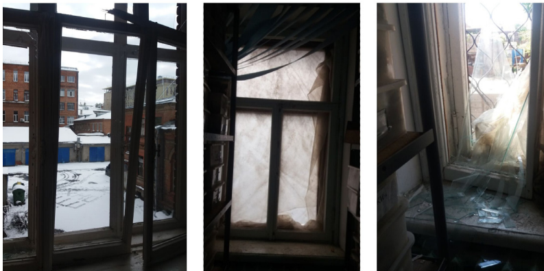
Фото 2. Музейні приміщення по вул. Трінклера після обстрілів у березні 2022 р. (фото з архіву авторки).
